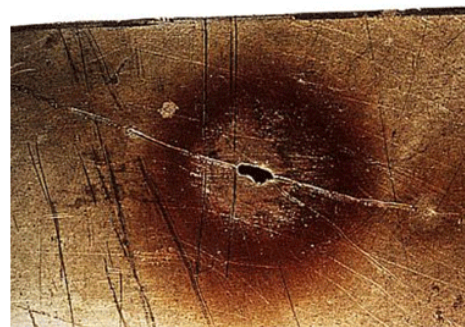
Пример коррозии нержавеющей стали 1.4571
