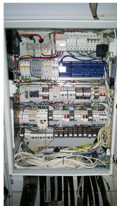
Рис. 3. Щит управления с ПЛК OMC-8000 до подключения
